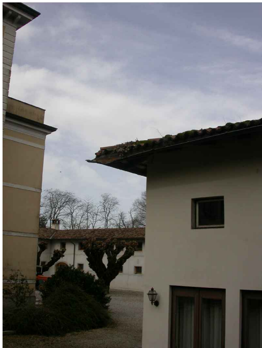
G_Angolo Sud-Est della Barchessa La grondaia e l'angolo del tetto sono in parte danneggiati e da ripristinare. Auspicabile la risagomatura della lattoneria.
