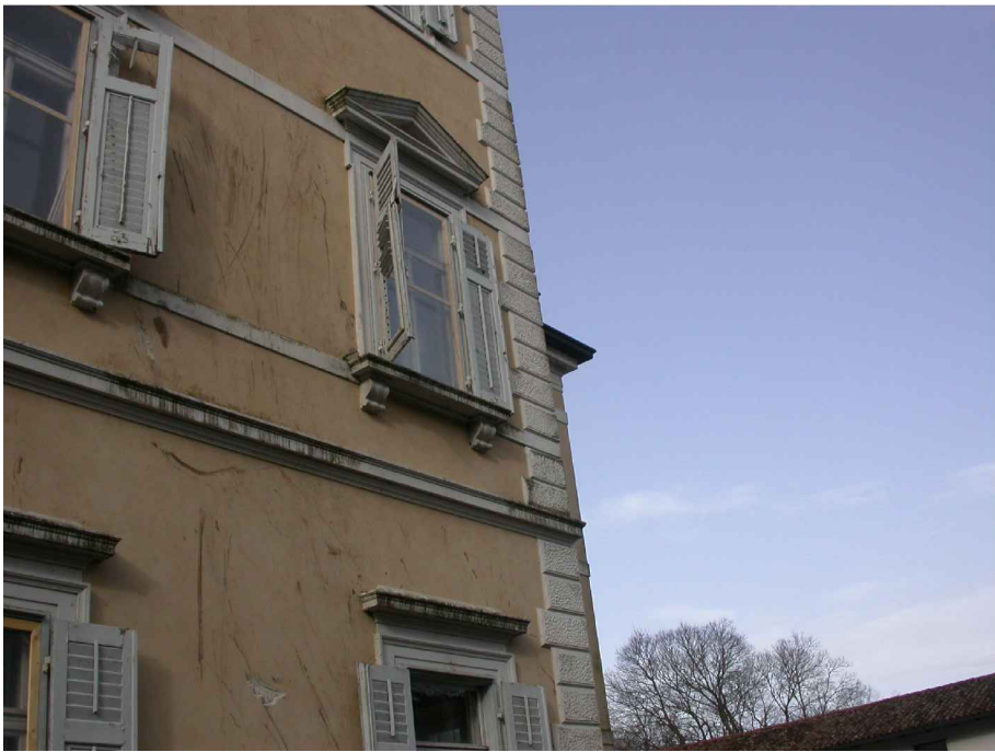
A_Parte destra della facciata Nord-Est. Risulta danneggiata dalla caduta di un albero. In alcuni punti l'intonaco si è staccato. Si evidenziano danni a scuri e finestre con rottura dei vetri e dei telai lignei.
