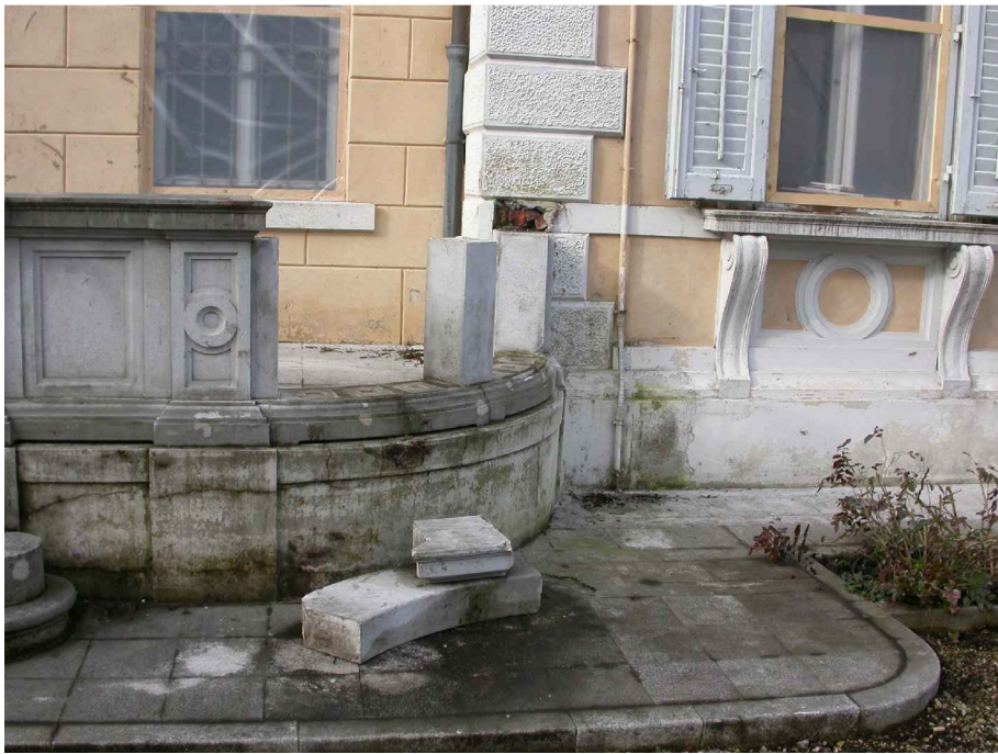
C_Balaustra d'entrata La parte destra risulta completamente danneggiata, gli elementi a terra sono complementari e possono essere ricomposti con piccole integrazioni.
