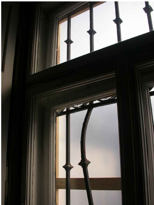
F_Inferriata finestra al PT Evidenti segni da piegatura sotto l'azione del carico elevato. Se ne prevede la risagomatura a caldo.
