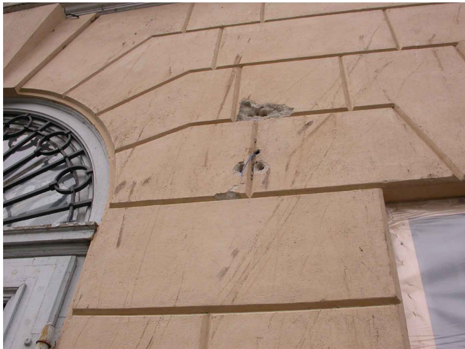
E_Lampione Il lampione è stato divelto assieme ai relativi tasselli di fissaggio a muro, ai cavi elettrici ed a parti d'intonaco in finto bugnato. Prima della ricollocazione in opera del lampione opportunamente ricablato,vanno ripristinati il fondo dell'intonaco e la connessione elettrica.
